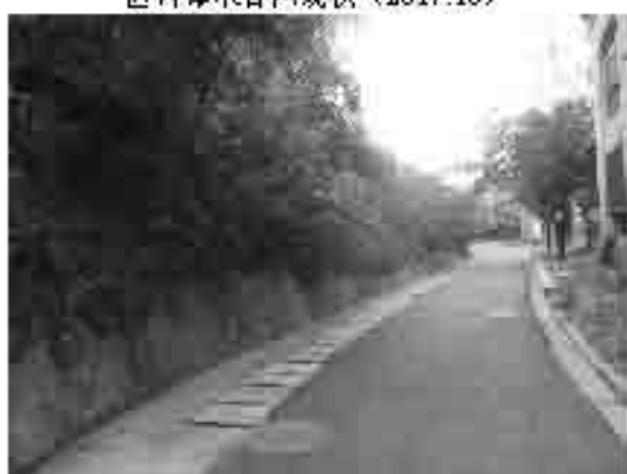
区内排水管网现状 (2017.10)
