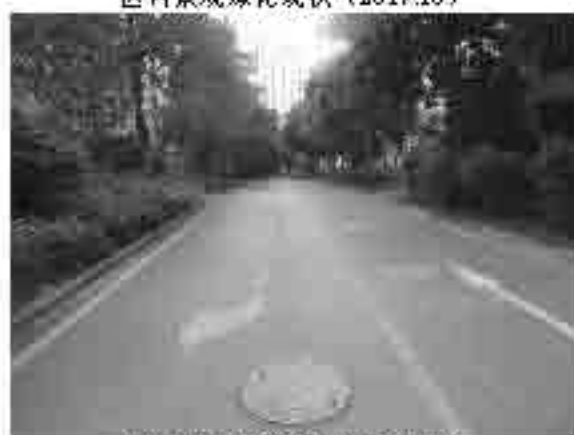
区内排水管网现状 (2017.10)
