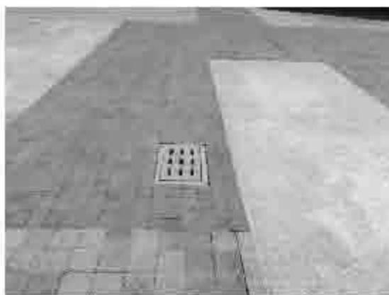
已建成雨水管网现状 (2018.7)
