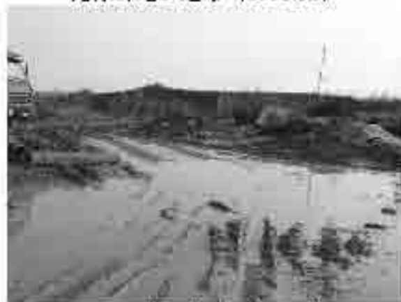
泥泞的施工道路 (2017.3)
