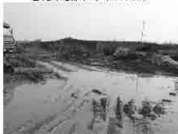
泥泞的施工道路 (2016.12)
