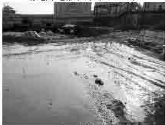
泥泞的施工道路 (2017.3)
