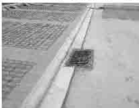
已建成雨水管网现状 (2018.12)
