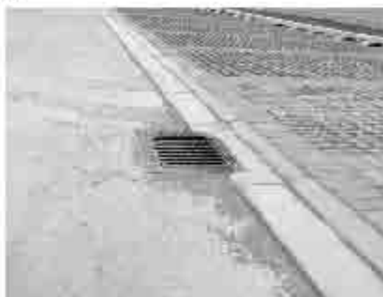
已建成雨水管网现状 (2018.12)
